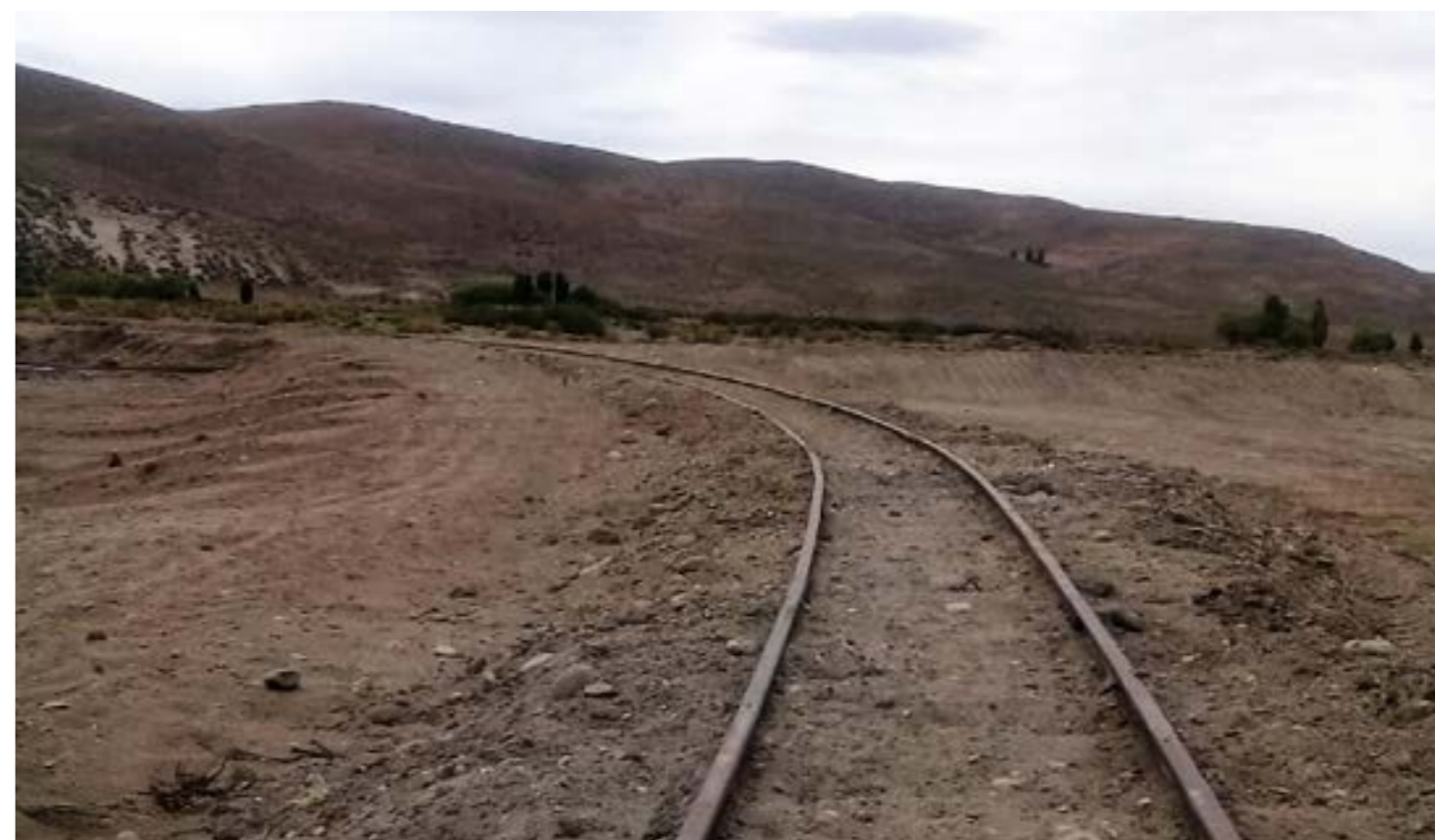
En esta foto se ve el trabajo realizado en la vía y como quedó puesta en condiciones.
